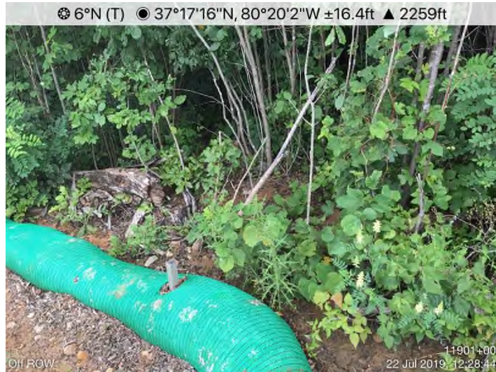
Fig. 5: STA 11901+00 – Sediment off ROW.
